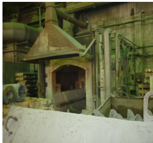
Рисунок 9 – Загальний вигляд камерної печі з викатним подом
